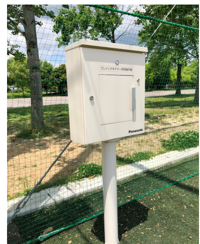
照明点灯操作 Box
